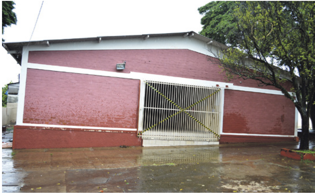
EM. José Osken de Novaes teve que ser interditada por conta do teto e paredes estarem comprometidos
